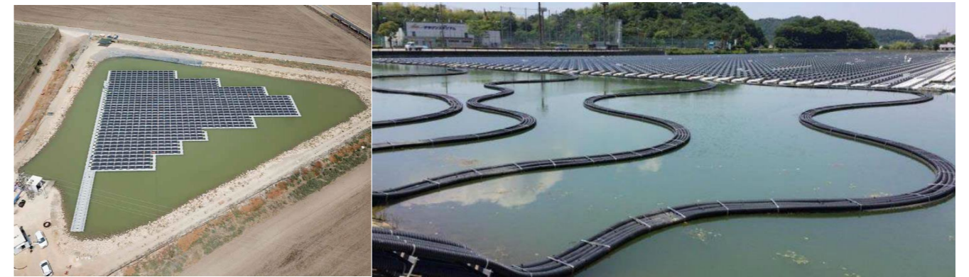
Figure 6 : Exemple de pontons et de câbles utilisés sur les centrales photovoltaïques flottantes (Source : C&T)
