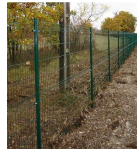
Figure 49: Exemple de clôture installé sur les parcs photovoltaïques
